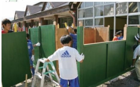
みなかみ町で行われたハウス作り。地元の大工の方々のアドバイスを受けながら、メンバーが協力。完成したハウスに宿泊もした
